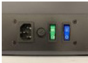
External switches Interrupteurs extérieurs
